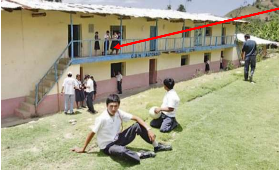
Foto: parapetos de madera con daños
