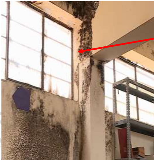
Foto: muro y columna afectado por humedad
