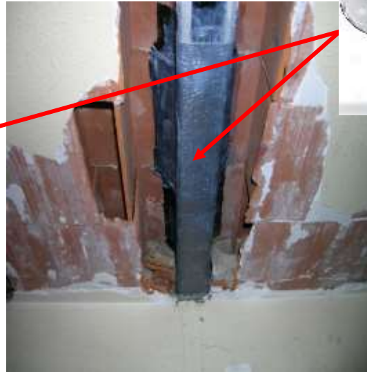
Foto: viga agrietada
