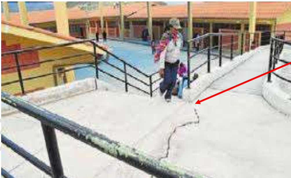
Foto: piso de concreto presenta grietas
