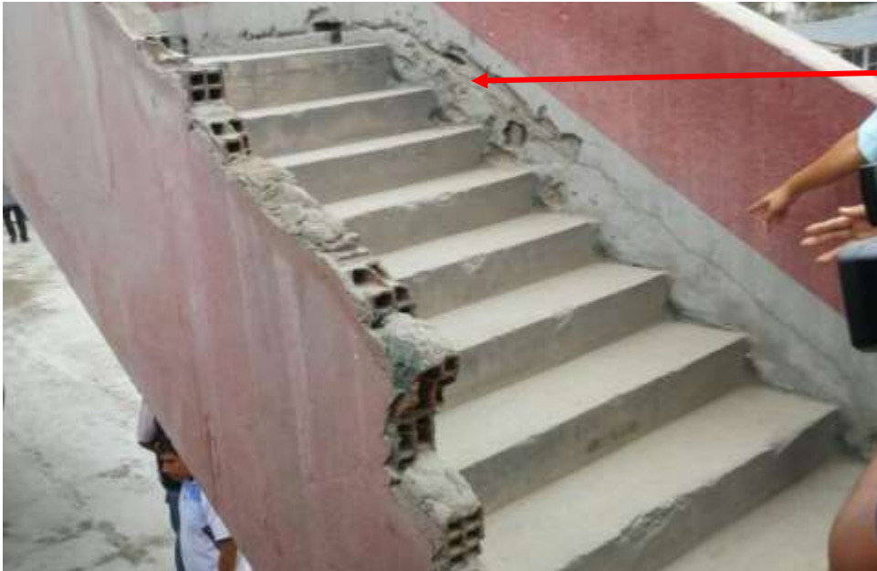
Foto: escalera de concreto presenta grietas
