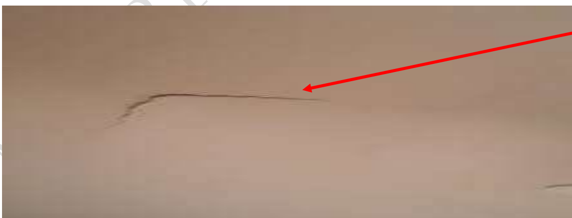
Foto: techo de concreto presenta fisuras.
