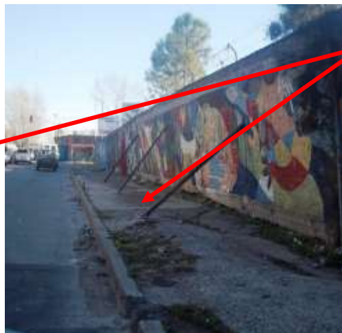
Foto: muro inclinado
