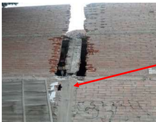
Foto: encuentros de columna separados
