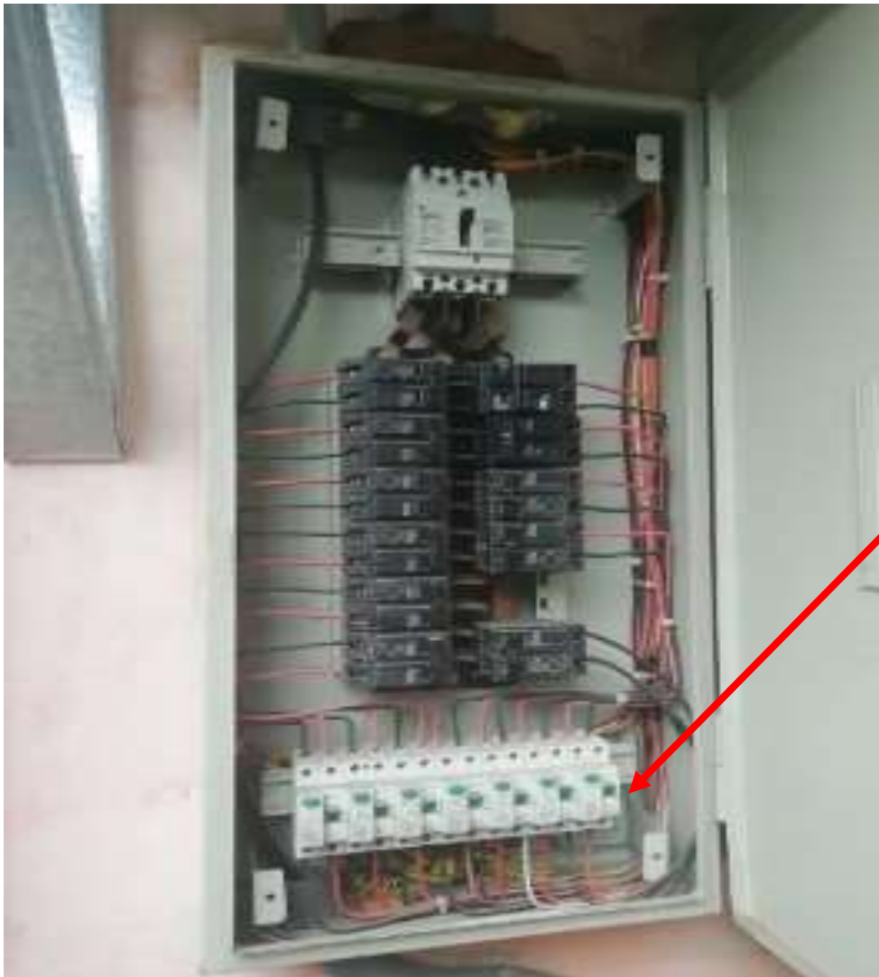
Foto: circuitos eléctricos con protección de interruptores diferenciales
