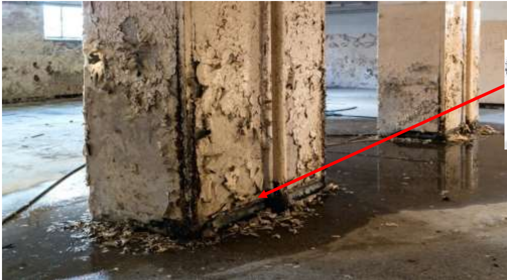
Foto: cimentación expuesta por filtraciones de agua
