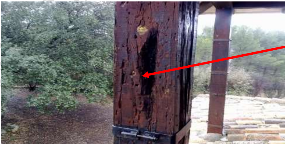
Foto: columnas de madera apolilladas
