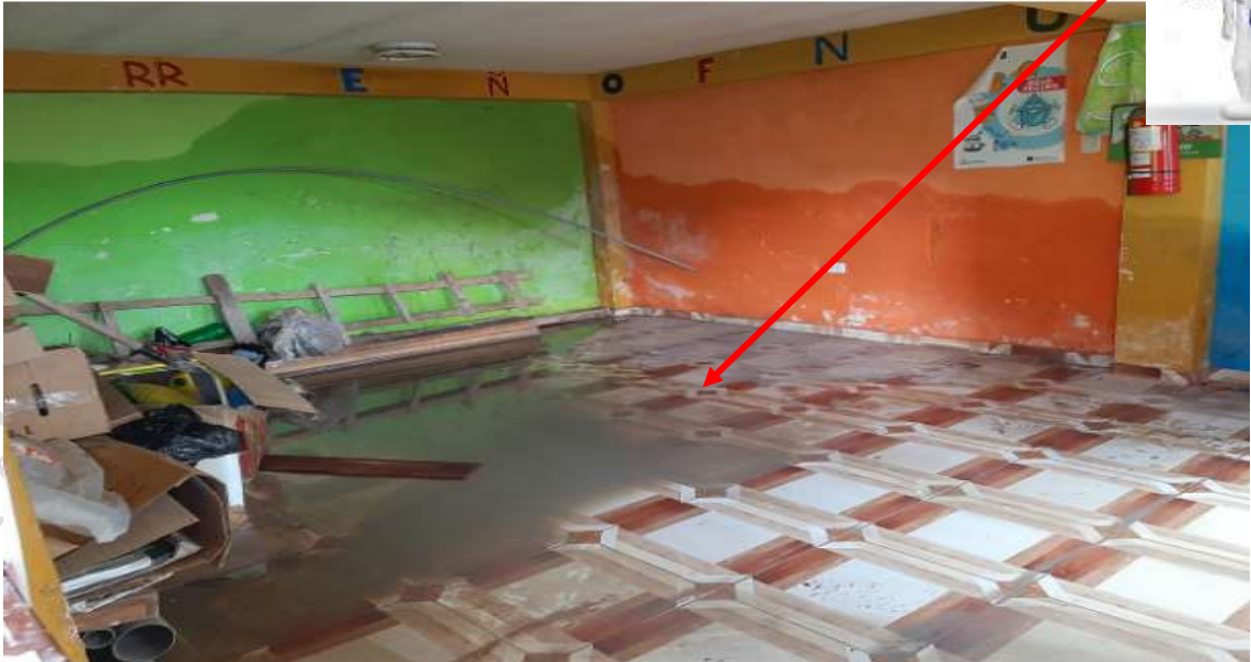
Foto: muro de ladrillo presenta daños por humedad
