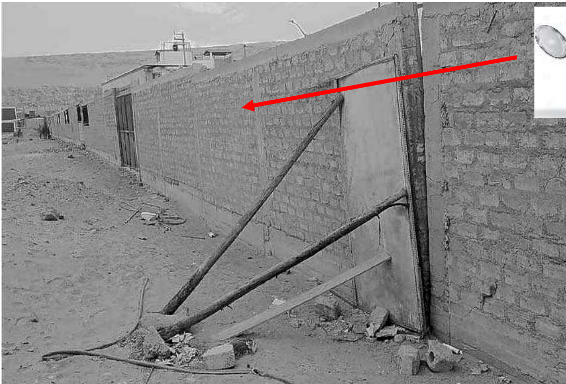
Foto: cerco perimétrico presenta daños por inclinaciones
