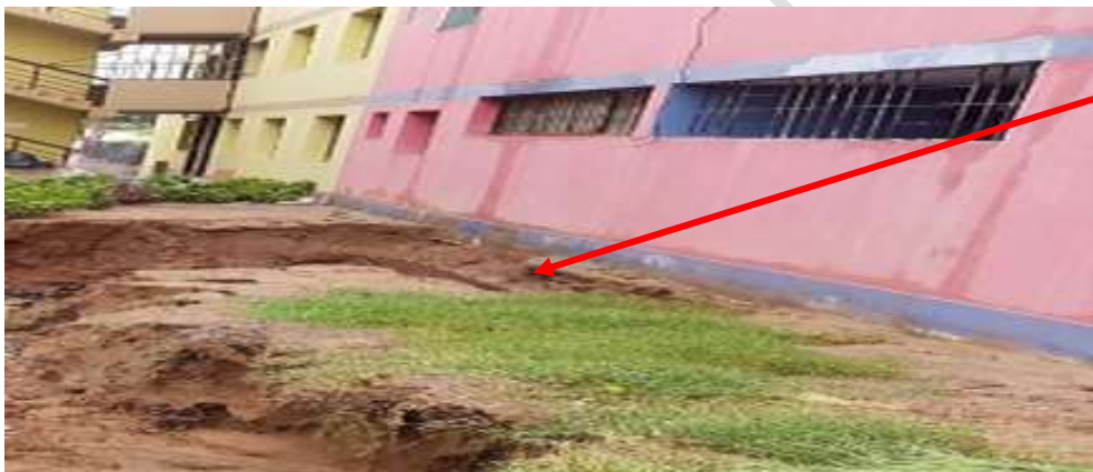
Foto: cimentación expuesta como consecuencia de la erosión por lluvias
