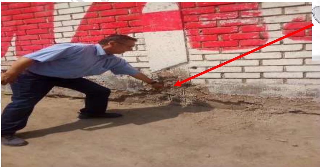
Foto: cerco perimétrico de ladrillo presenta daños (varillas de acero expuestas a la intemperie)
