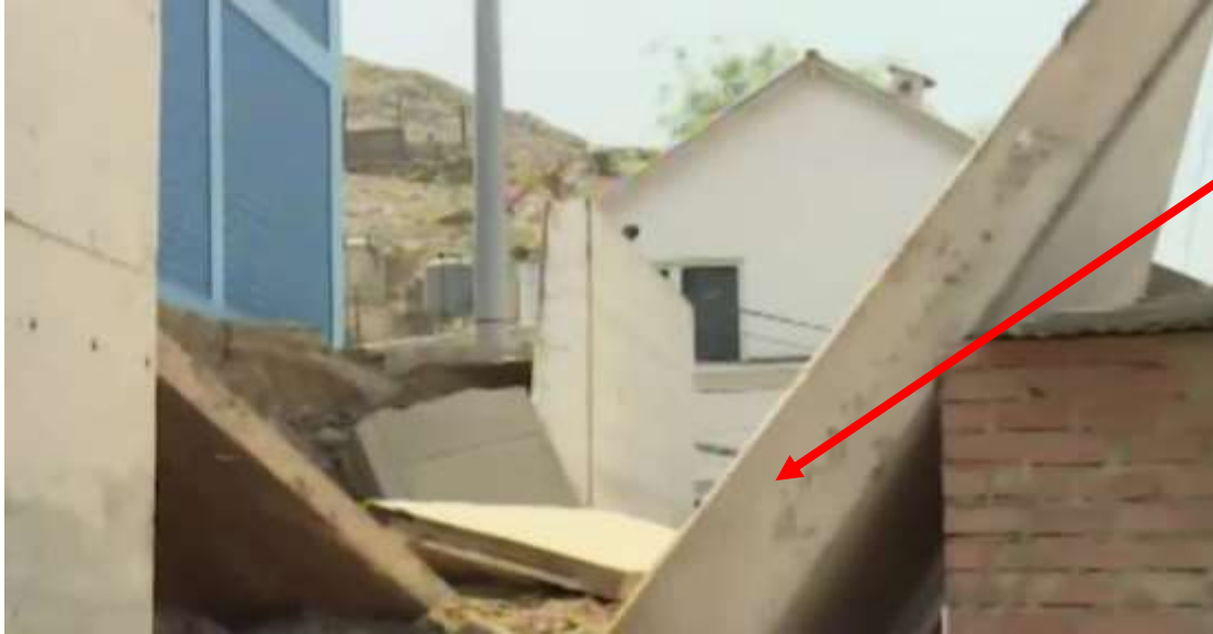
Foto: muro de contención en cerco perimétrico de concreto cae
