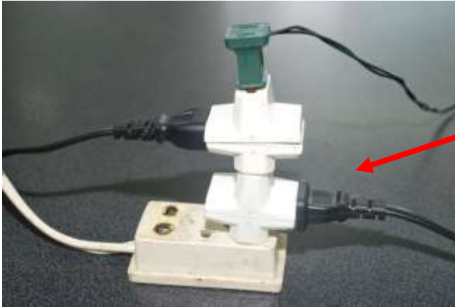
Foto: tomacorrientes sobrecargados
