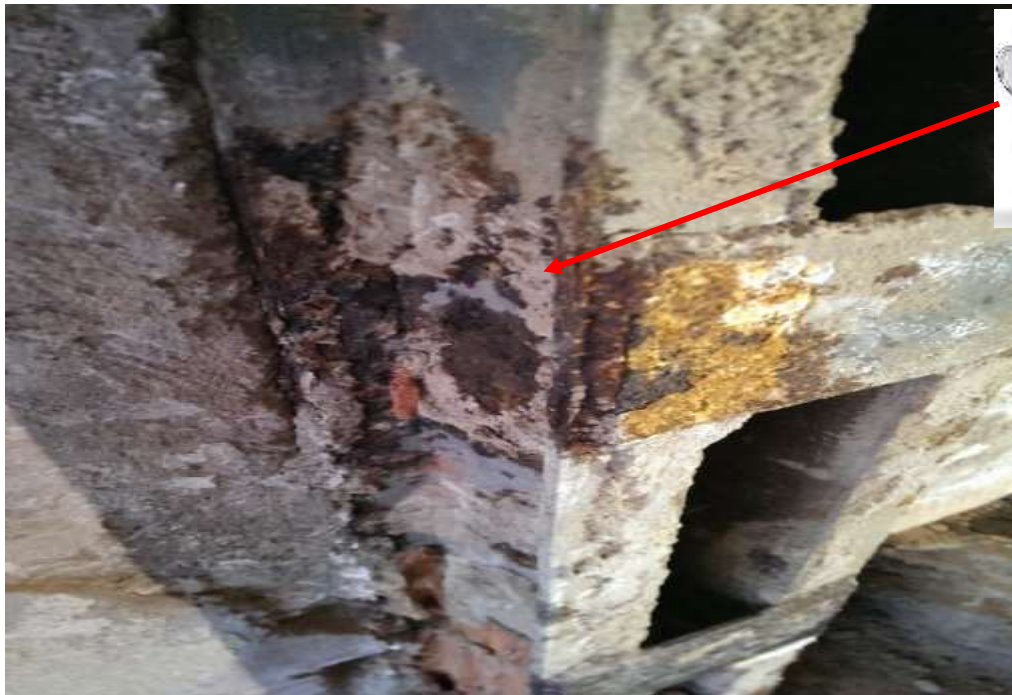
Foto: deterioro por oxido o corrosión
