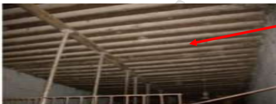
Foto: viguetas de madera con rajaduras
