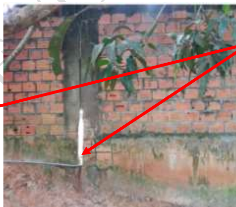
Foto: encuentros de columna agrietada
