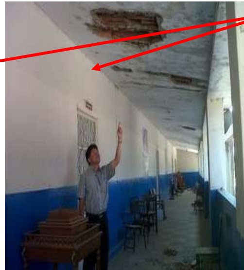
Foto: techo presenta humedad
