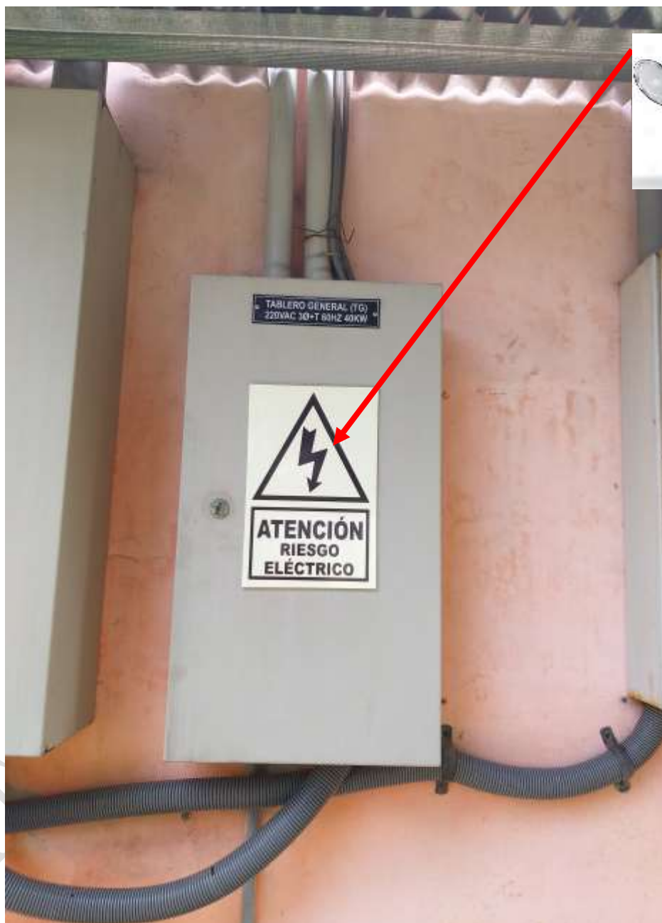
Foto: el tablero general tiene señalización de seguridad de riesgo eléctrico en la tapa
