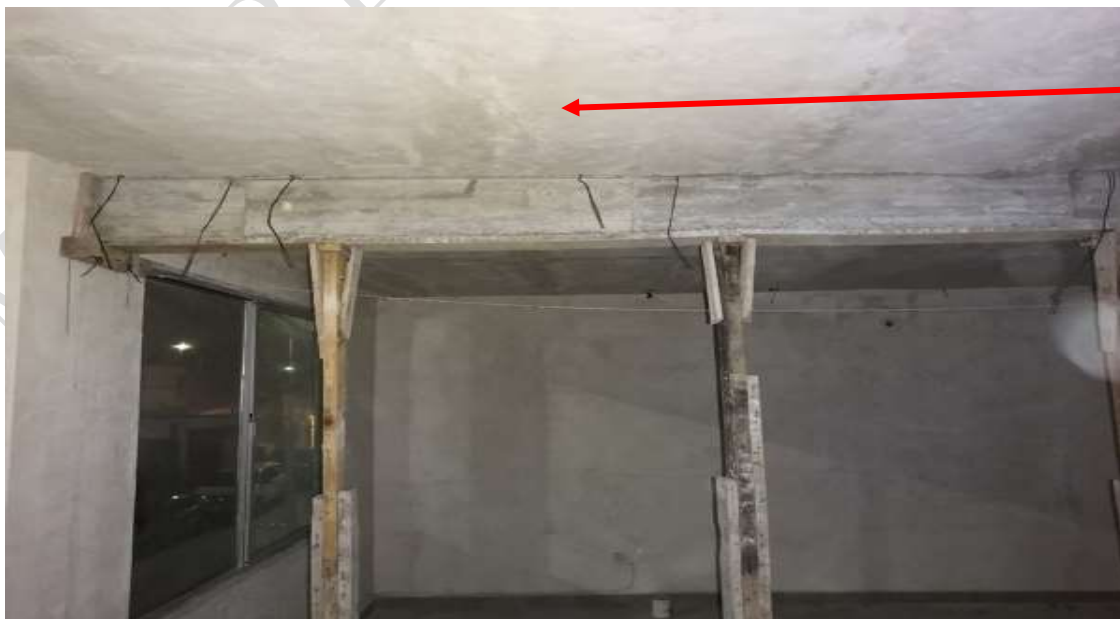
Foto: techo presenta daños por pandeo
