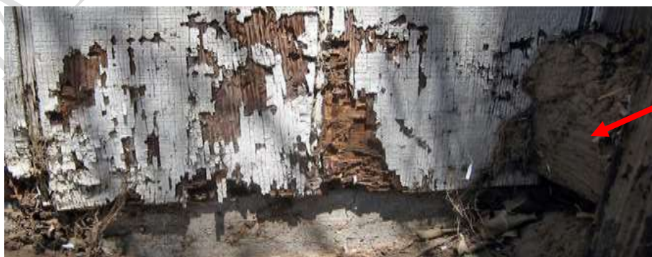
Foto: muros de madera apolillados
