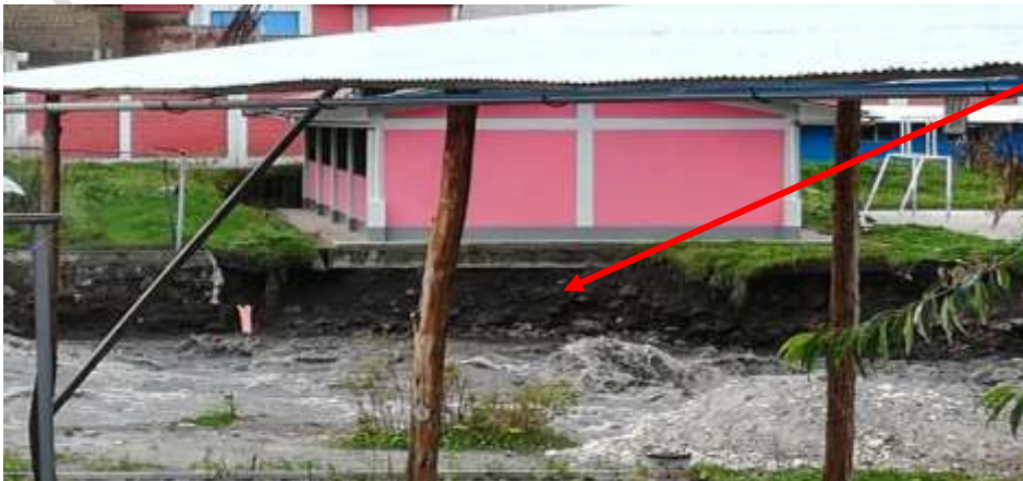
Foto: cimentación expuesta por socavamiento.
