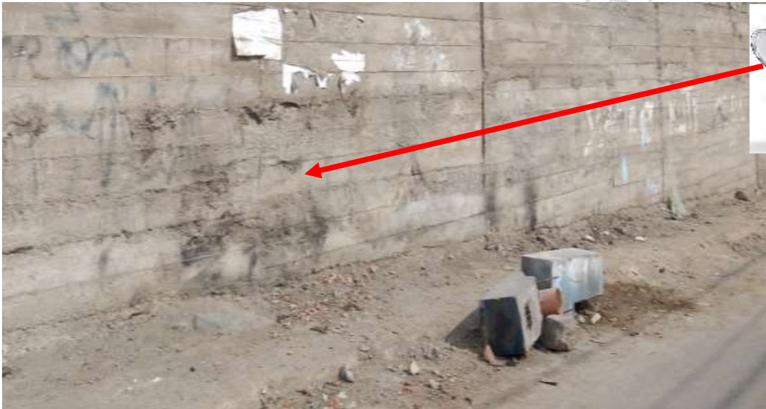
Foto: cerco perimétrico de concreto presenta grietas
