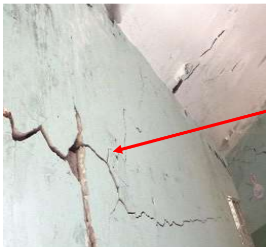
Foto: muro agrietado
