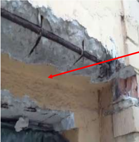
Foto: vigueta agrietada
