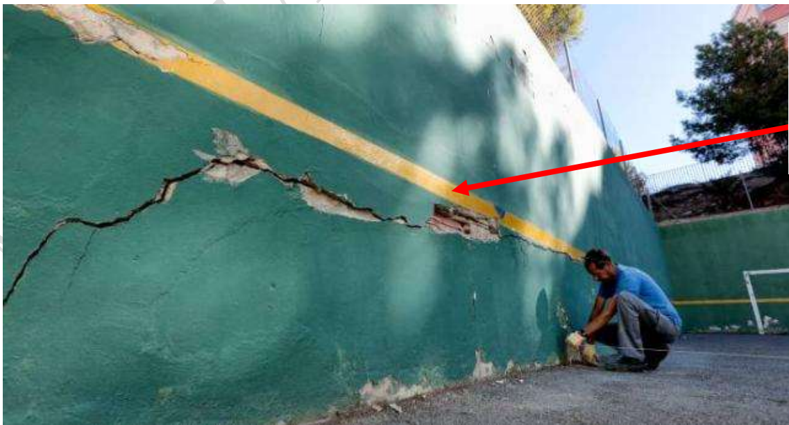
Foto: cerco perimétrico de ladrillo presenta daños por grietas
