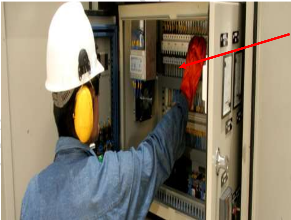
Foto: el tablero eléctrico con mantenimiento
