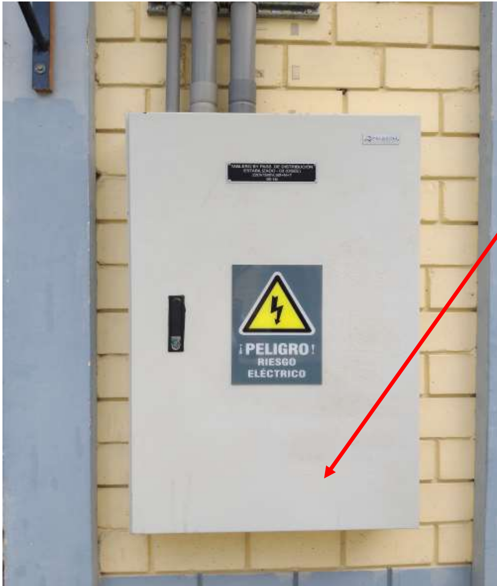
Foto: el tablero de distribución tiene señalización de seguridad de riesgo eléctrico en la tapa
