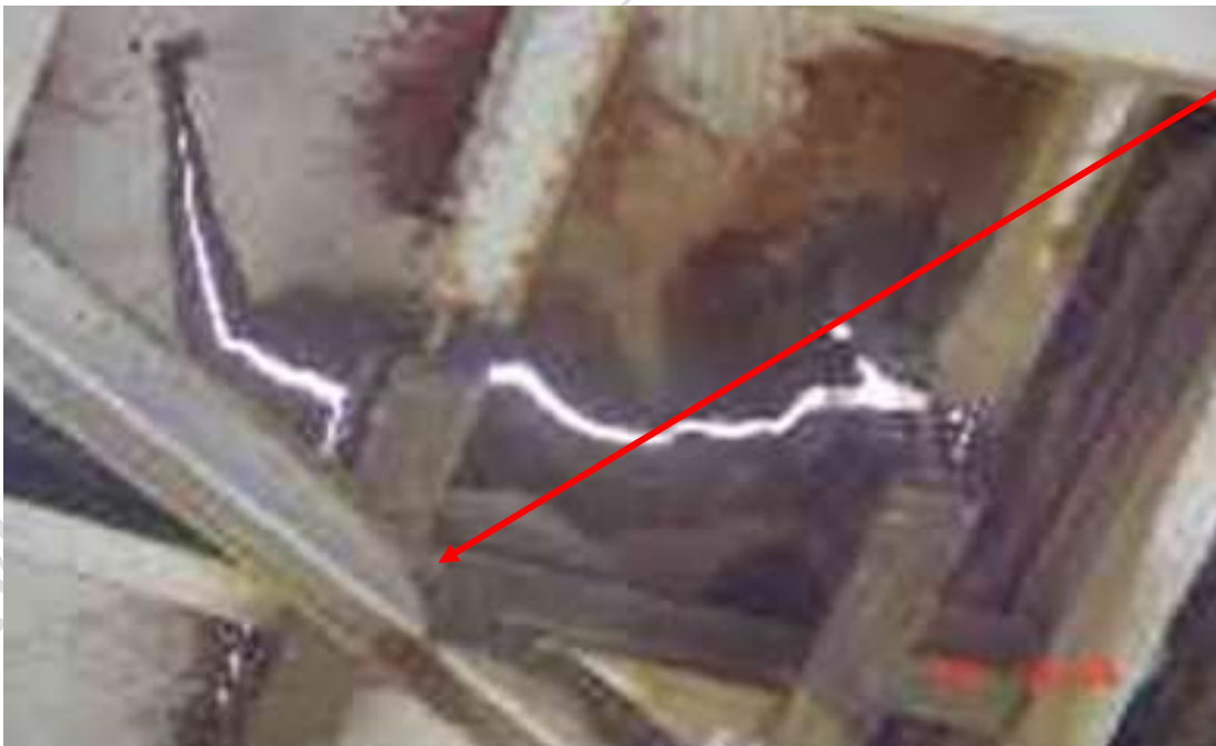
Foto: corrosión en plataformas
