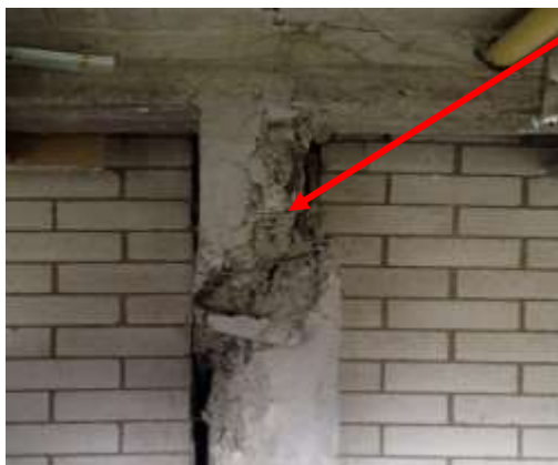
Foto: columna fracturada
