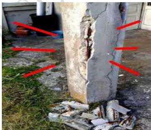
Foto: columna fracturada
