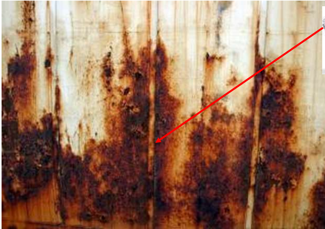
Foto: defectos en las uniones de paneles
