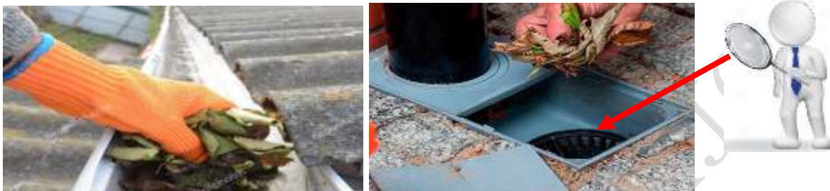
Foto: limpieza periódica de los sistemas de captación y drenaje
