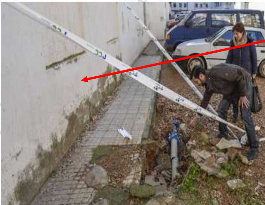
Foto: tuberías de desagüe presentan fugas
