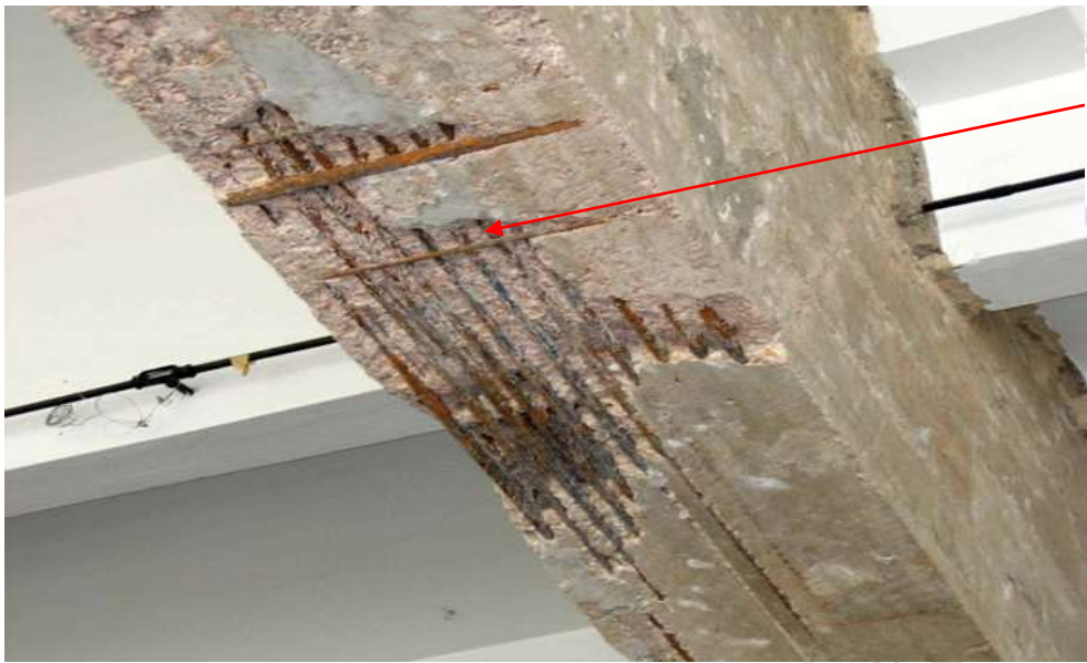
Foto: viga de concreto presenta deterioro por humedad producido por tuberías rotas
