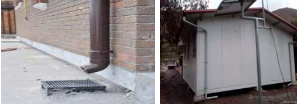
Foto: El desfogue está conectado a la red pública de drenaje pluvial
