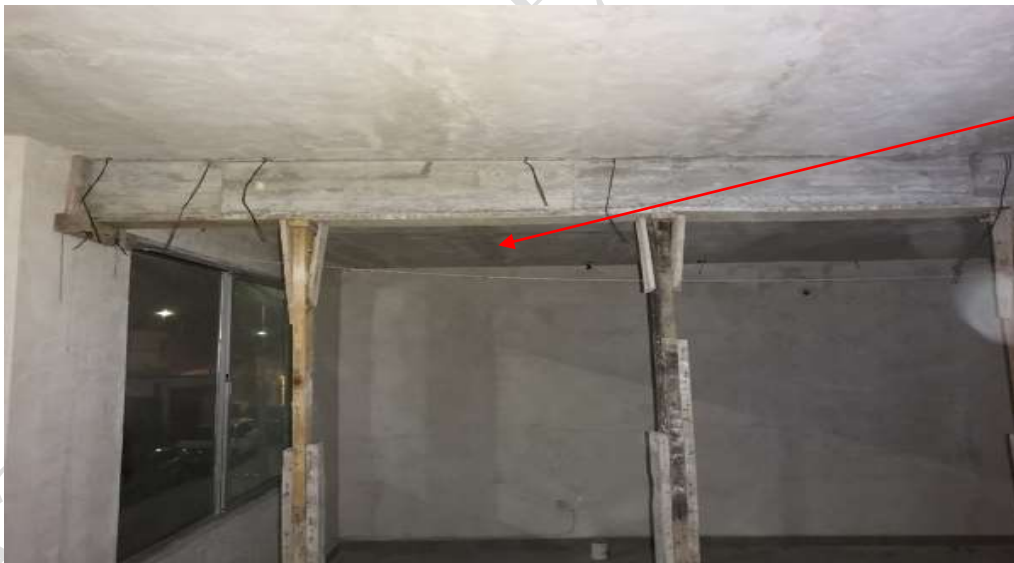
Foto; viga con pandeo
