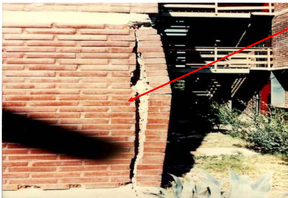
Foto: muro de ladrillo presenta daños por grieta
