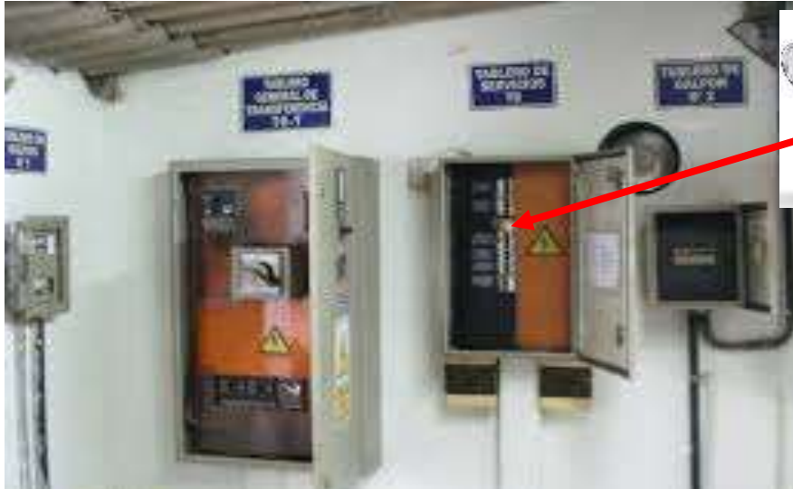
Foto: cuarto de tablero cuenta con señalización
