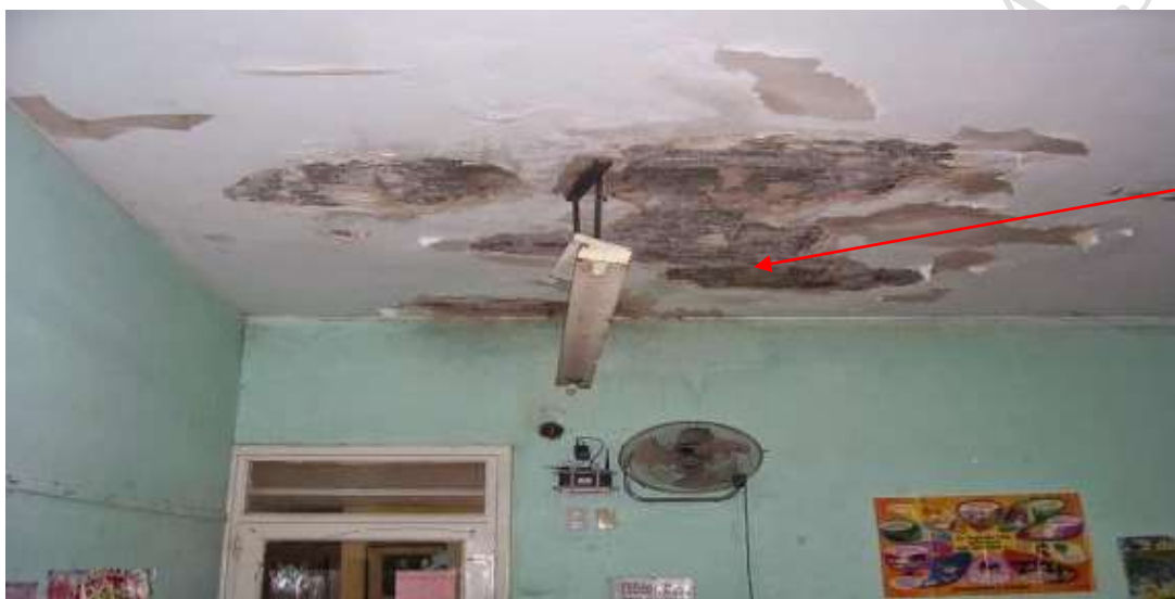
Foto: columna presenta deterioro por humedad producido por tuberías rotas de agua.
