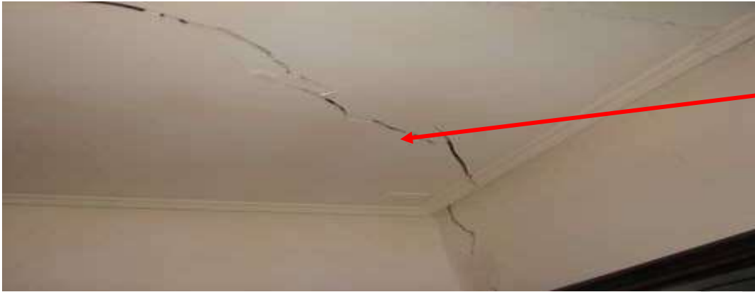
Foto: techo de concreto presenta grietas
