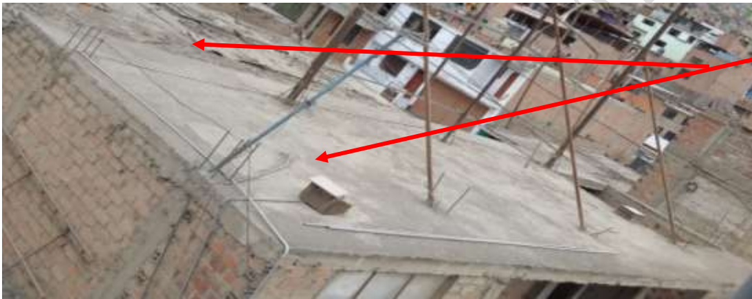
Foto: techo con varillas de acero expuestas
