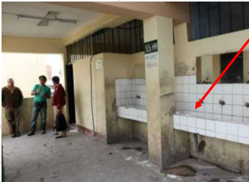
Foto: falta de mantenimiento de instalaciones sanitarias
