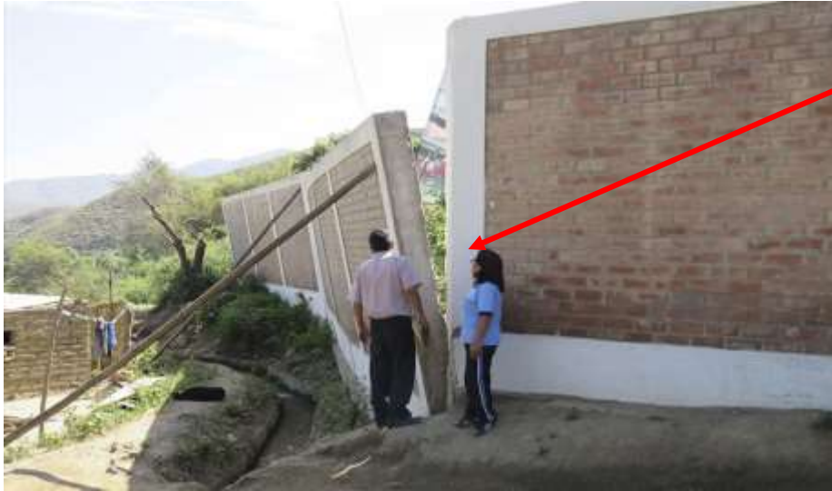
Foto: muro de ladrillo presenta daños por inclinaciones
