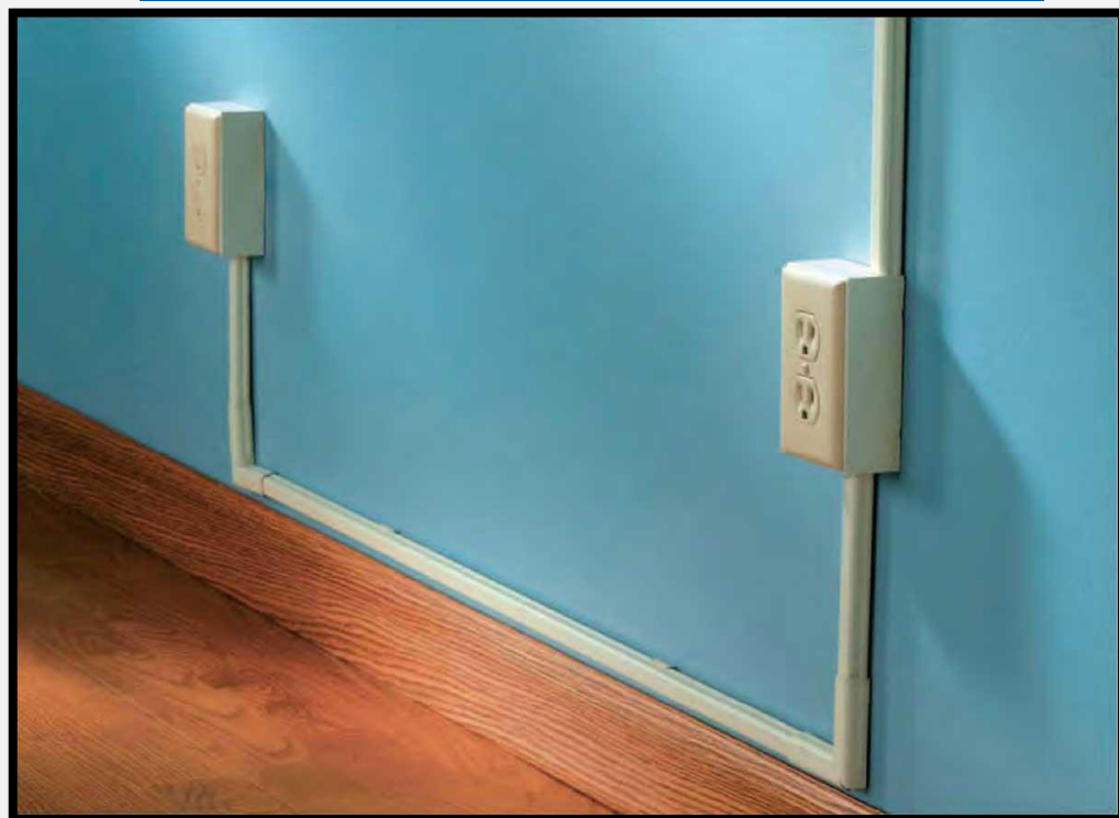
Cod 01: Circuito canalizado
