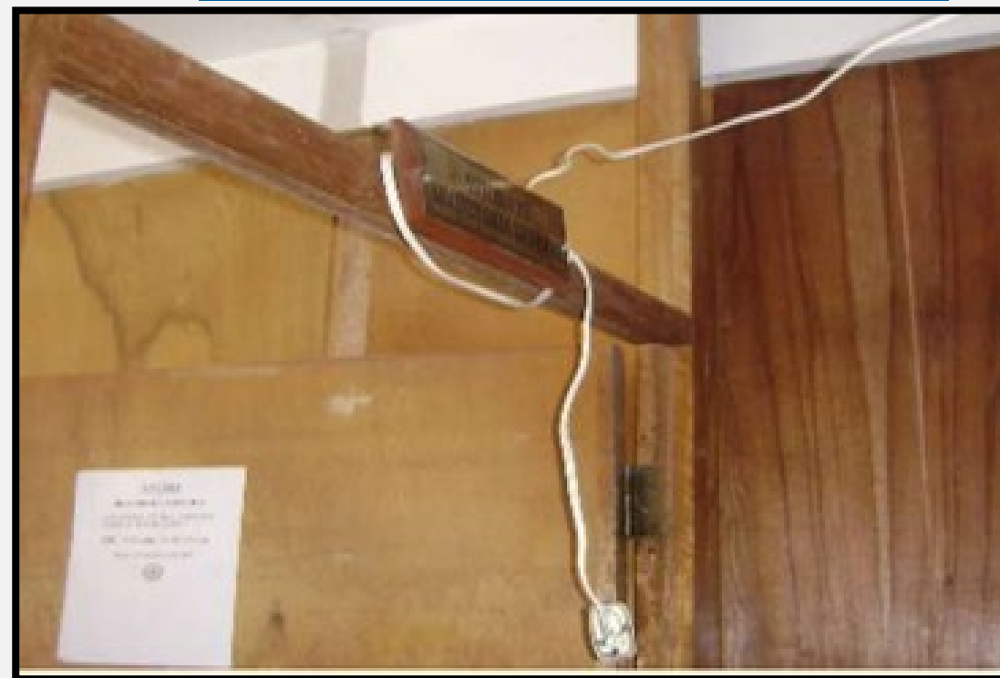
Cod 02: Circuito sin canalizar
