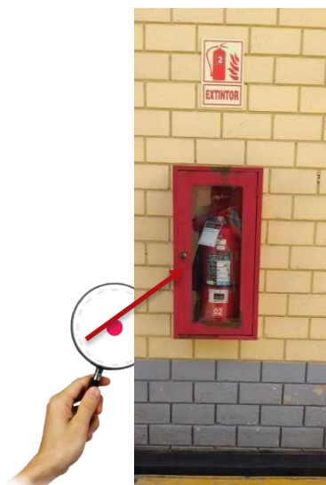
Imagen 5: Gabinete para extintor
