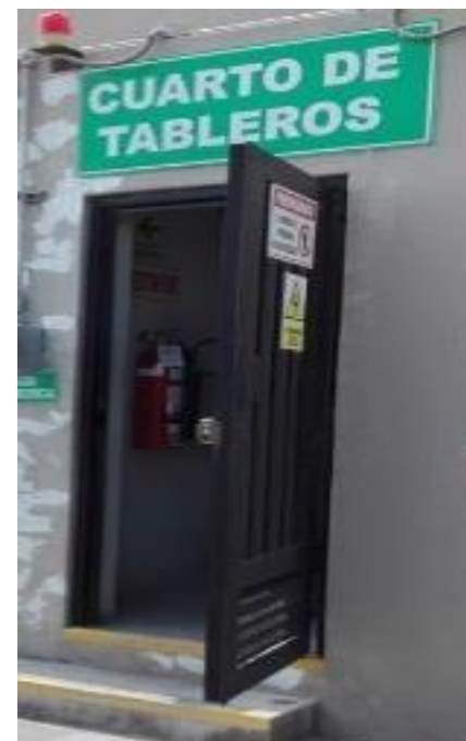
Imagen 23: Cuarto de tableros cartel de riesgo eléctrico
