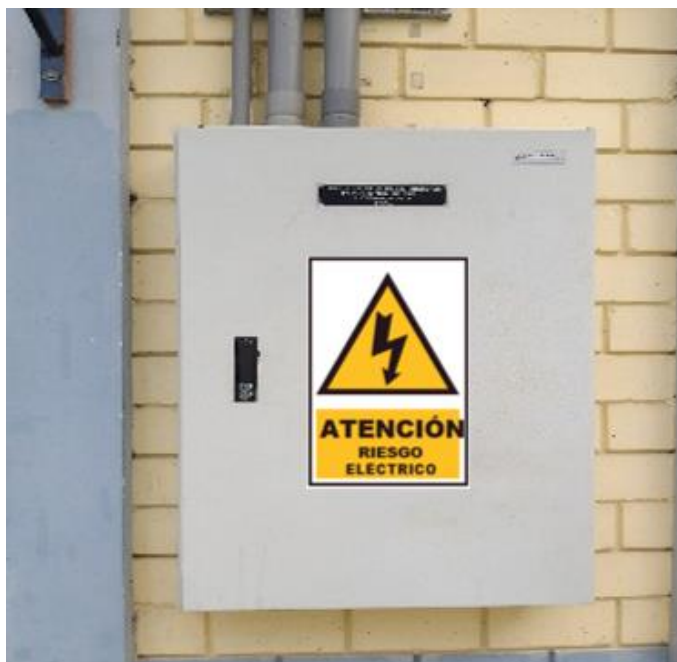
Imagen 22: Tablero eléctrico con cartel de riesgo eléctrico
