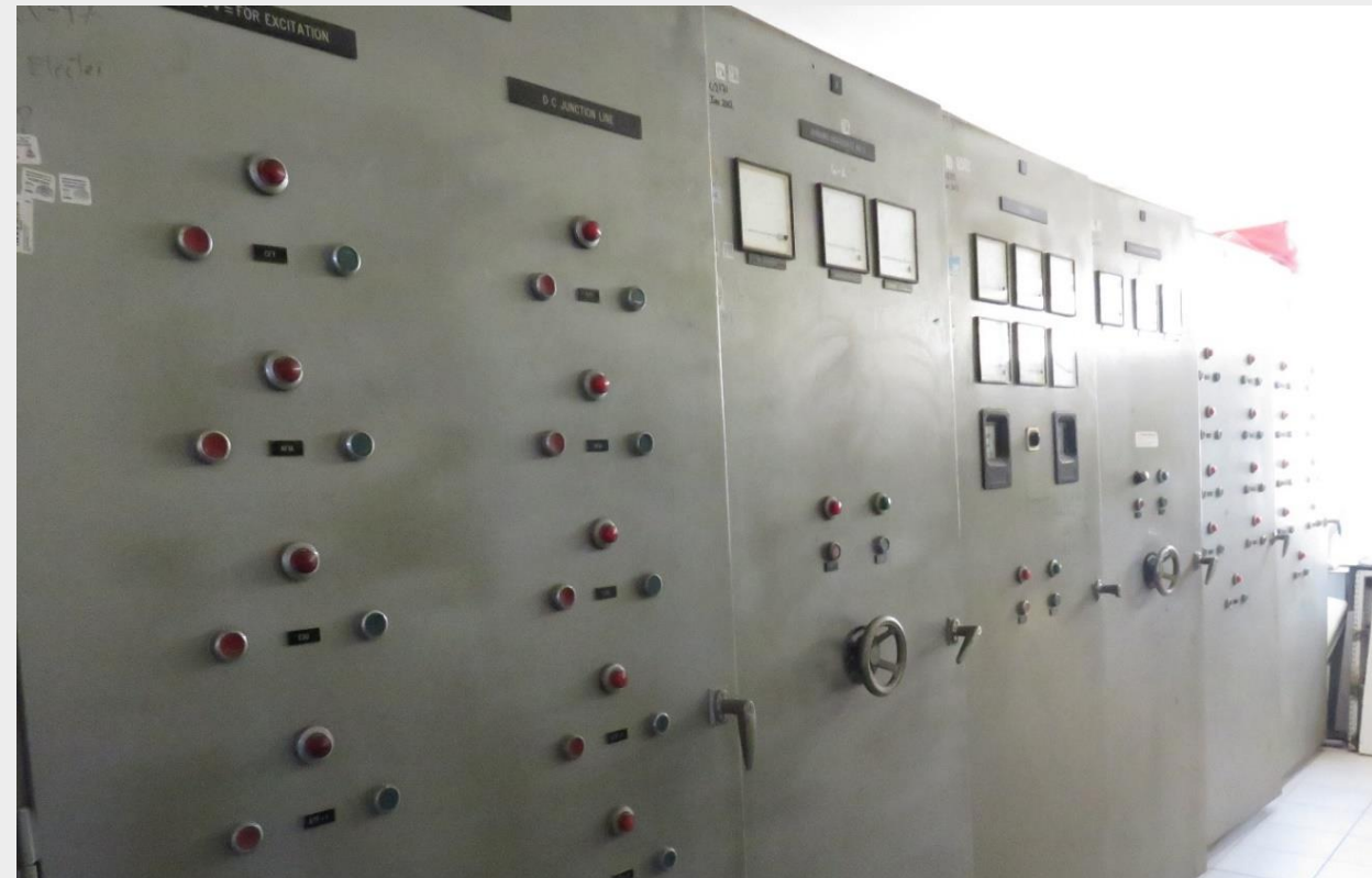
Sala de control eléctrico, IEST Simón Bolívar. Bellavista, Callao
