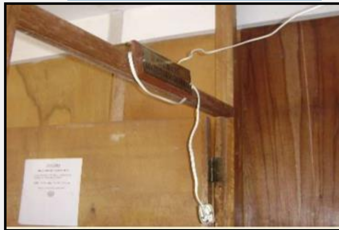
Cod 02: Circuito sin canalizar
